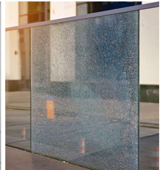
일반 강화, 저철분 강화 유리 파손 형태
